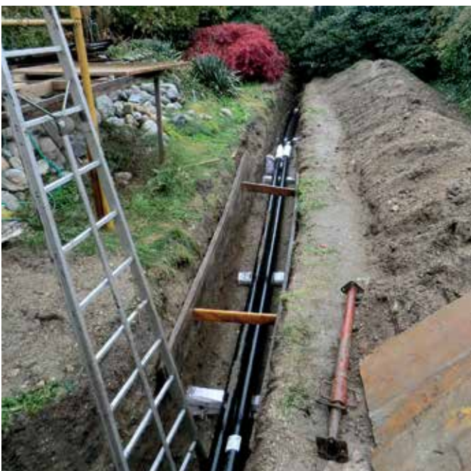
Fernwärmehanschluss in der Elisabethsiedlung
